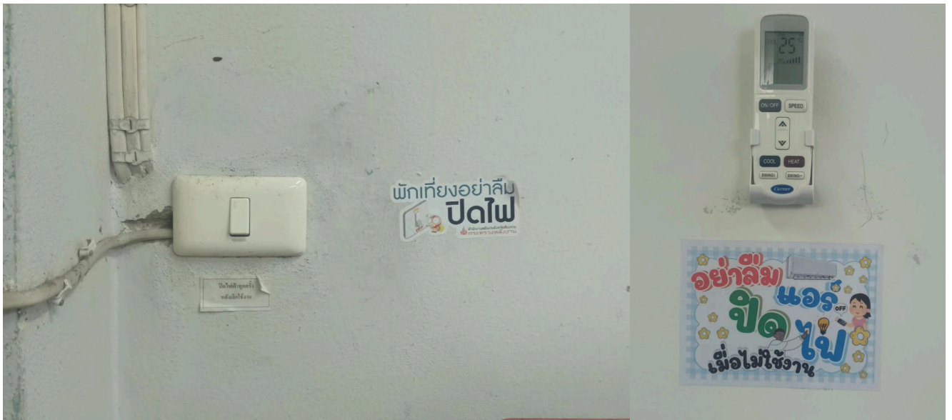
ติดป้ายเตือน เปิด-ปิดไฟ / ตั้งอุณหภูมิเครื่องปรับอากาศ ๒๕ องศา
